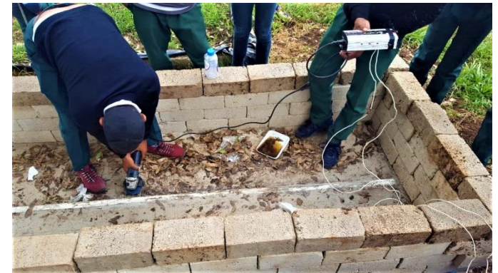
Alumnos del CBTA #230 adecuando el interior de las piletas lombricomposteras. San Juanito de Escobedo, Jalisco.
