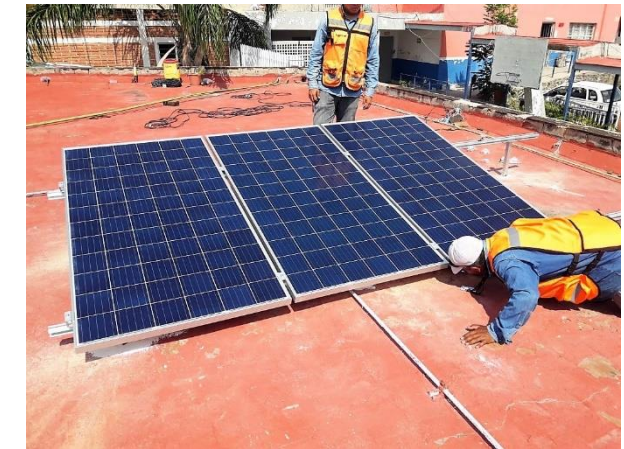
Visitas técnicas para la instalación de las celdas fotovoltaicas en los edificios del ayuntamiento de Cocula, Jalisco.
