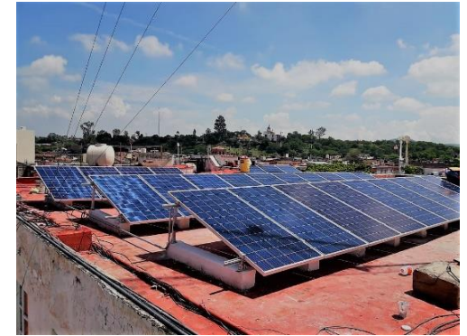
Sección de las celdas fotovoltaicas instaladas en edificios públicos municipales. Cocula, Jalisco.
